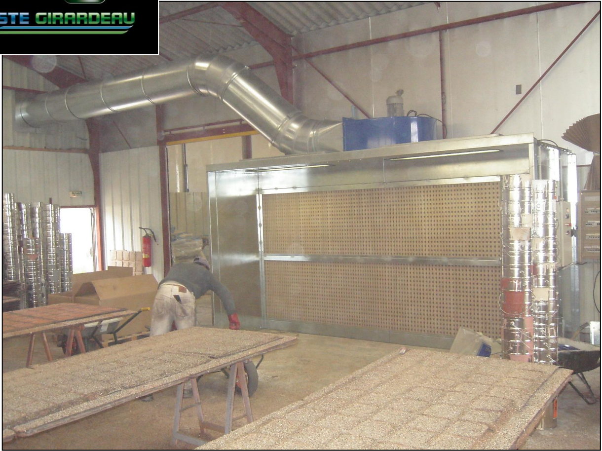
CABINE SECHE POUR LA PREPARARTION DES RESINES
