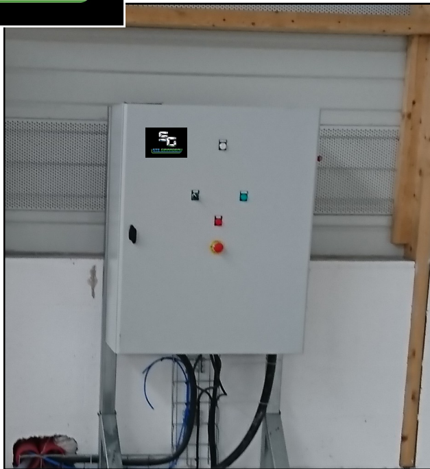
Coffret électrique GIRARDEAU
